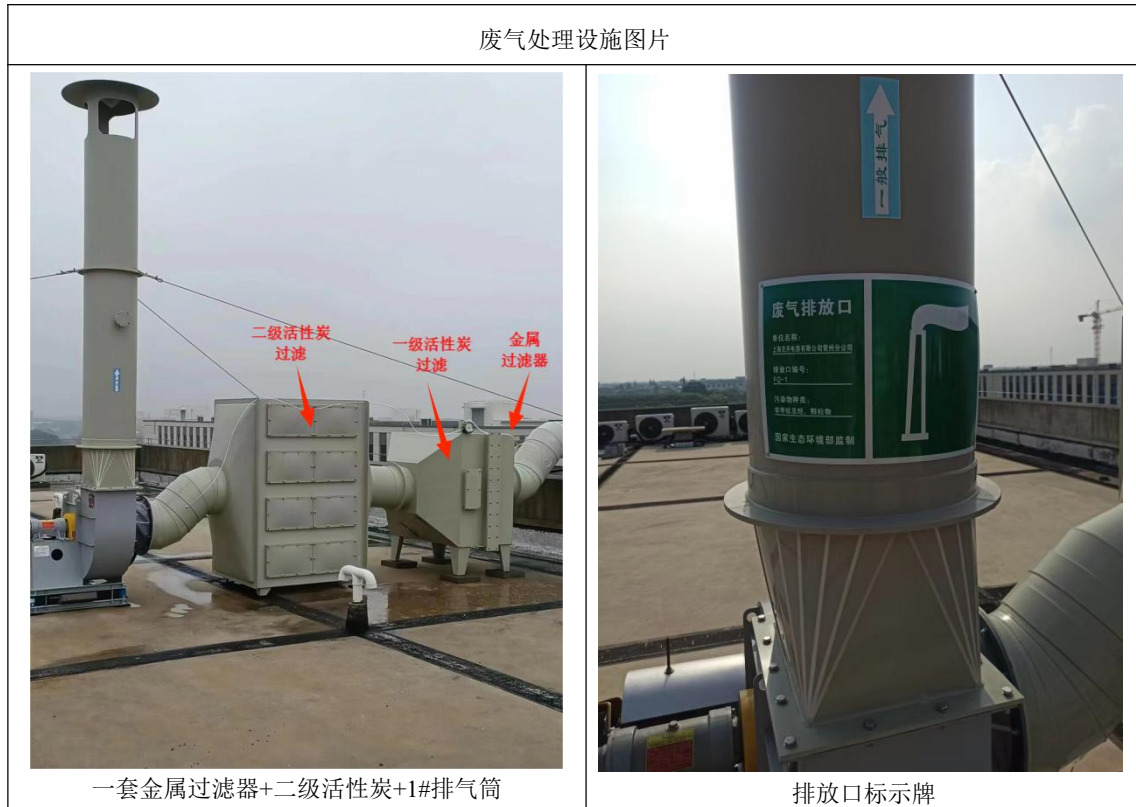
图 3-2 废气治理设施一览图
